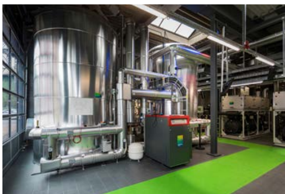
Das Herz der Energiezentrale mit den großen Behältern für heißes und kaltes Wasser.
