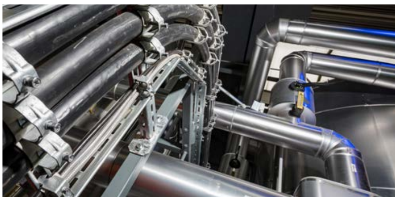
Ästhetisches Miteinander: Strom- und Wasserleitungen in der Energiezentrale
