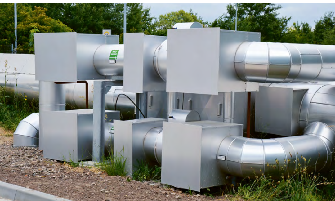
▲ Wärmeverteileranlage im Fernwärmenetz von Frankfurt (Oder).
