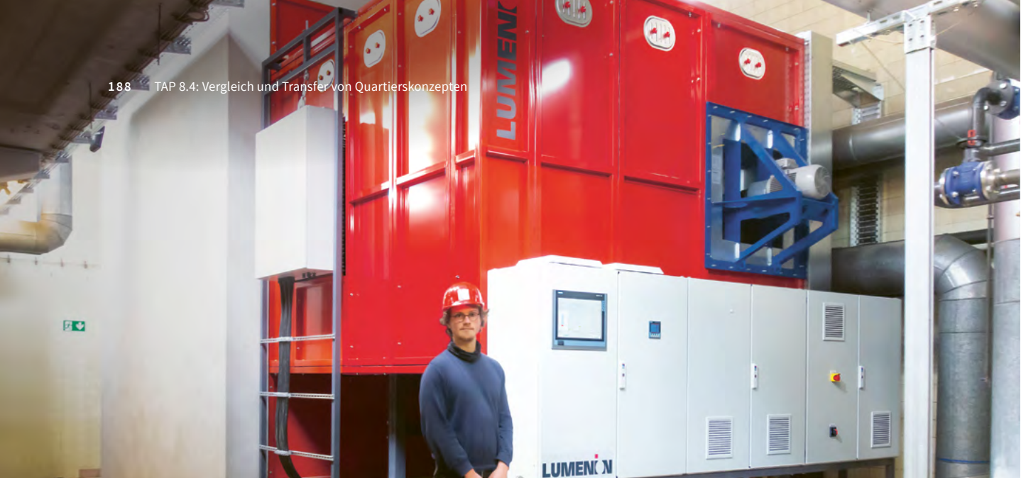
▲ Der Lumenion-Hochtemperatur-Stahlspeicher in Berlin-Reinickendorf.
