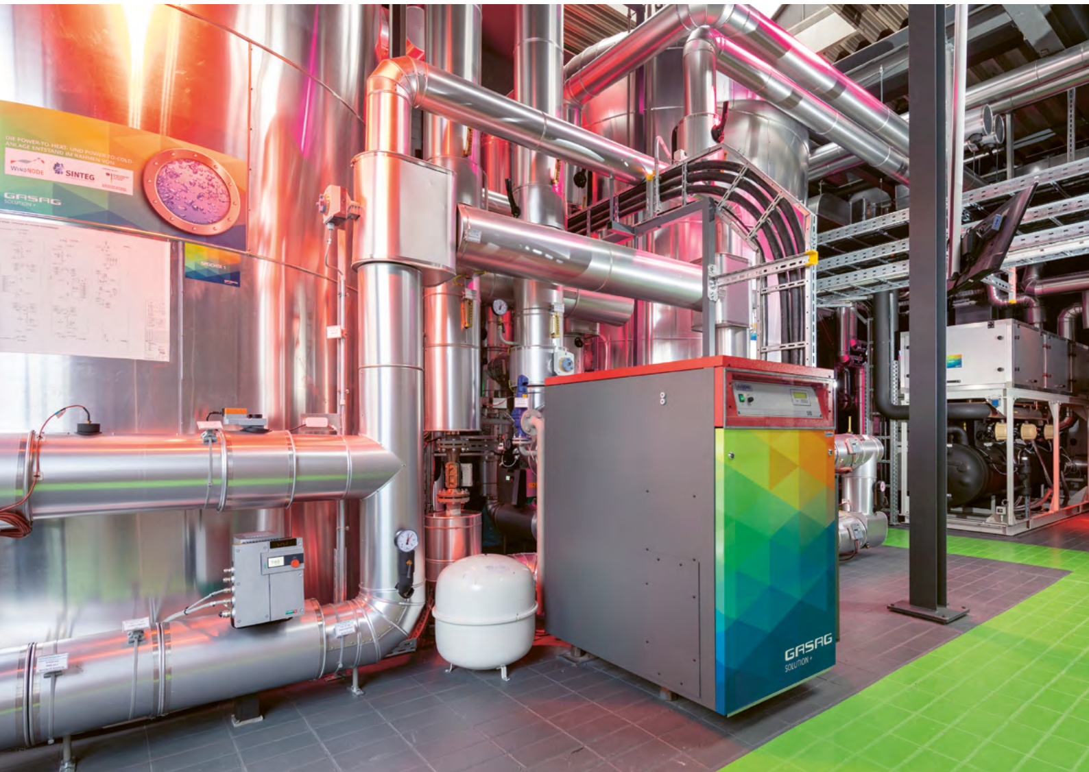
▲ Besuchbarer Ort der Energiewende – die deutschlandweit erste PtH/PtC-Anlage befindet sich in der EUREF-Energiewerkstatt by GASAG Solution Plus.
