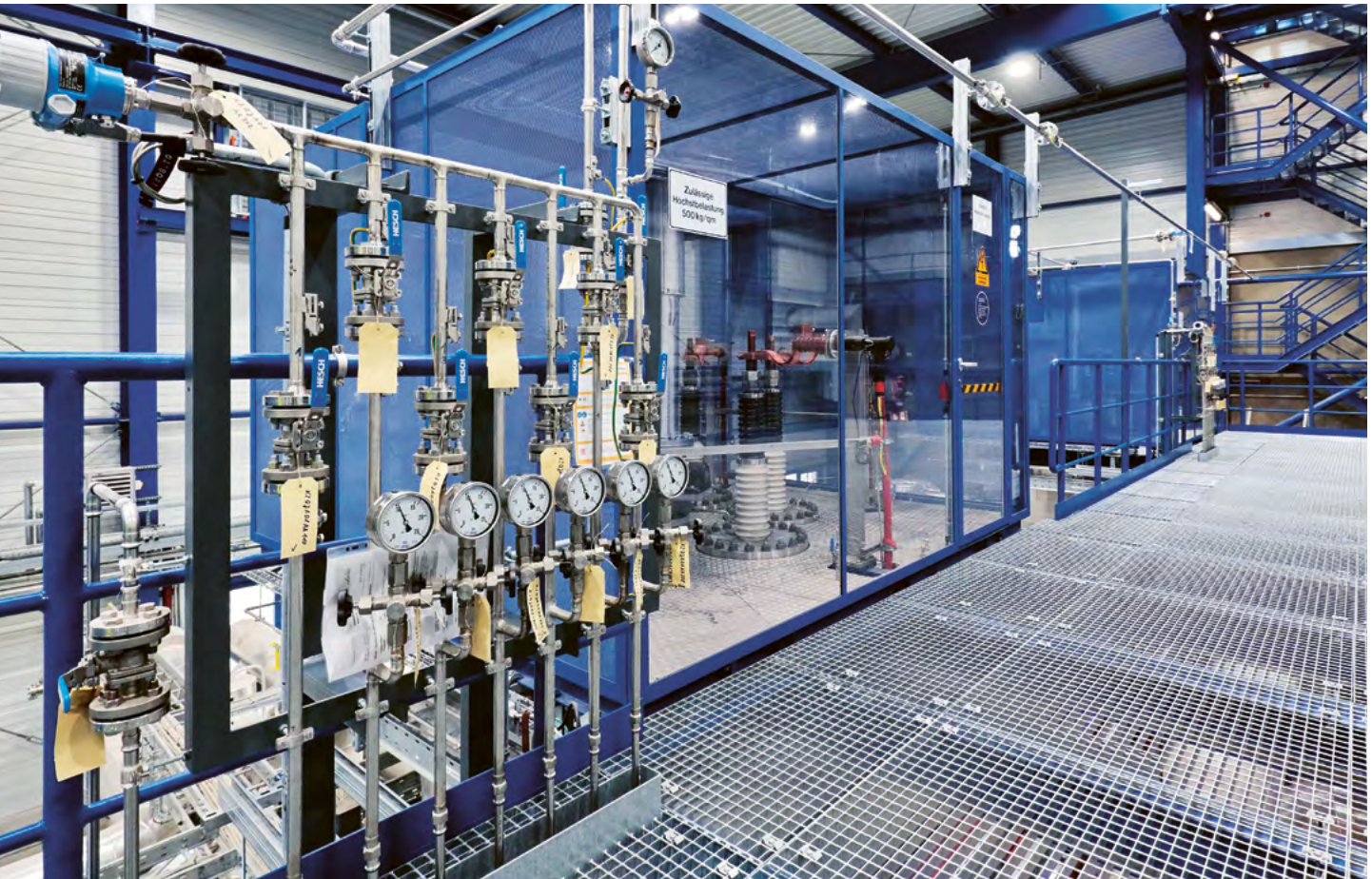
▲ Ebene 1 der Power-to-Fernwärme-Anlage, Blick auf die Köpfe der Elektroden und eine Entleerungsgruppe.
