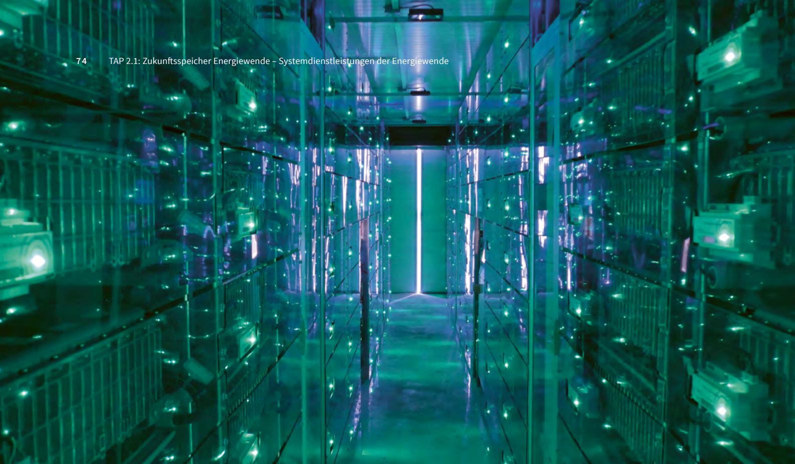
▲ Fahrzeugbatterien mittels moderner Steuerungstechnik über Funk im Einsatz in einem Container als Batteriegroßspeicher.
