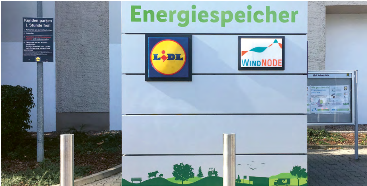
▲ Batteriespeicher vor der Lidl-Schaufensterfiliale in Berlin.
