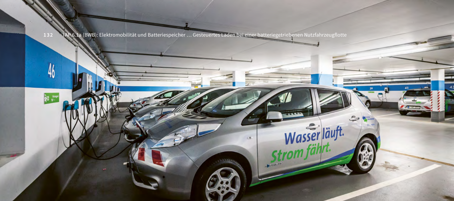
▲ E-Auto im Ladevorgang in einer Tiefgarage der BWB.
