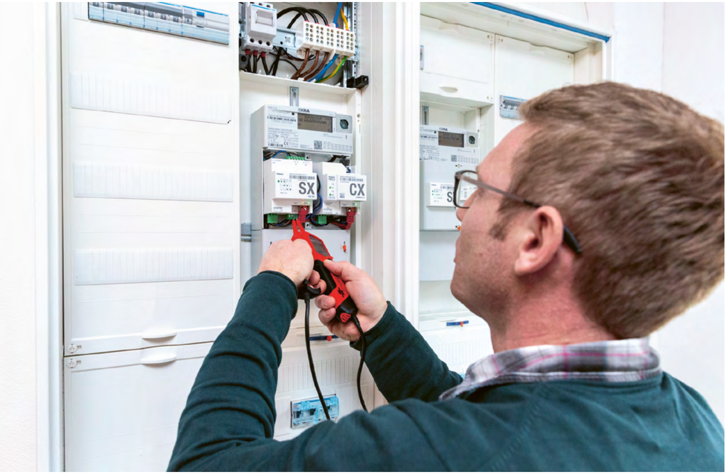
▲ Abnahme und Testschaltungen des ersten verbauten intelligenten Messsystems mit Steuerbox. Dieses schaltet hier die Fahrweise einer Wärmepumpe.
