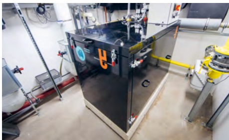
Blockheizkraftwerk im Heizkeller
