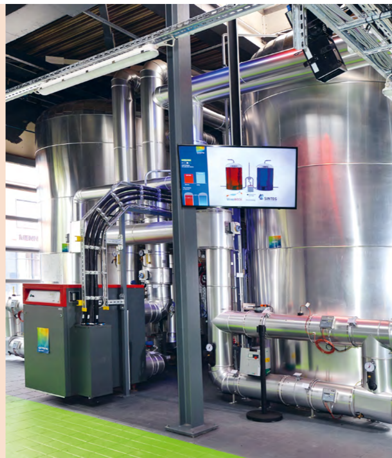
Die Power-to-Heat/Power-to-Cold Anlage reagiert mittels intelligenter Steuerung auf die aktuelle Marktsituation.
