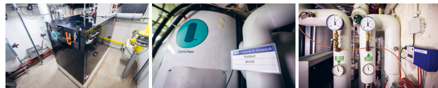
Blockheizkraftwerk im Heizkeller
